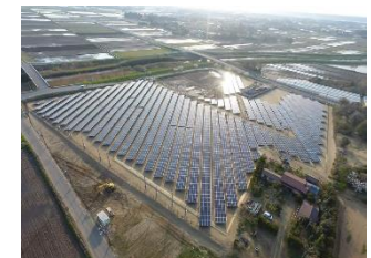
太陽光発電所 (写真は営農型)
